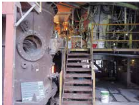
図16 再稼動した旧釜石市清掃工場の溶融炉 (2012.3.14撮影)
