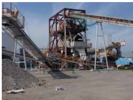
図10 細粒分の洗浄設備
