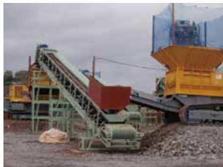
図8 破碎機による木屑を主成分とした可燃物のチップ化（2011.10.31撮影）
