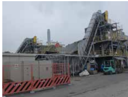
図22 宮古市の仮設焼却炉 (図18~22はいずれも2012.8.3撮影)
