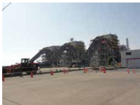
図14 仮設焼却炉(ストーカー炉)
